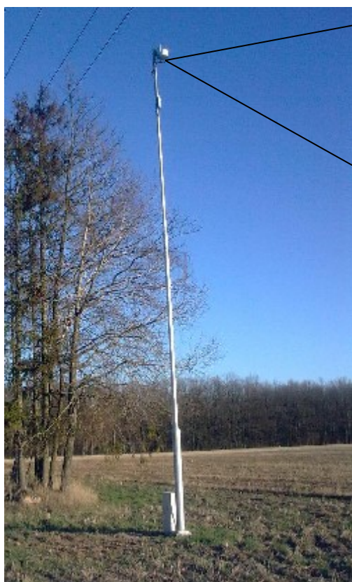
Hotspot zamontowany na słupie.
